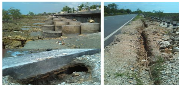
Gambar 2. Kerusakan Jalan Raya Camplong
