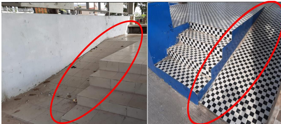
Gambar 7 Tangga tanpa handrail
